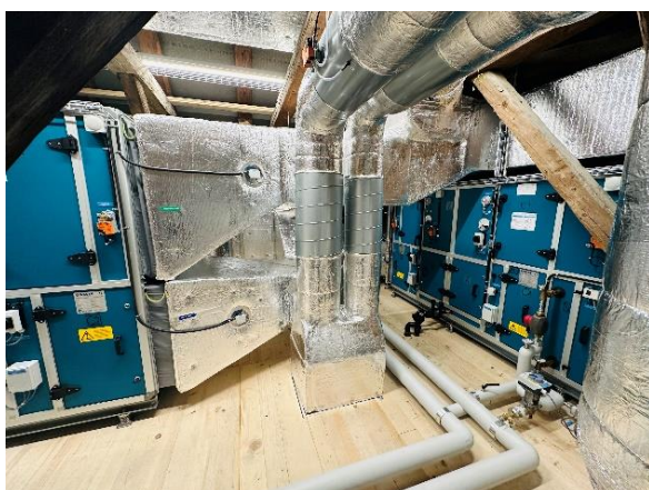
Monoblocke (Lüftung) im Dachstock
