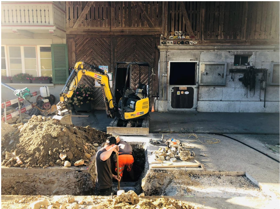
Wasserleitungsbruch beim Bauernbetrieb Lerchenboden
